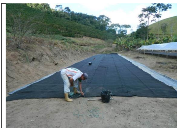
Construindo rapidamente o terreiro, sobre o terreno aplainado, coloca-se a lona e, acima, o sombrite.
